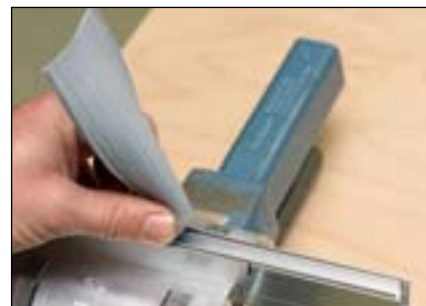
3 Dichtung einspannen und Dicht- profil bis hinter der Schnittstelle aus der Halteschiene ziehen
